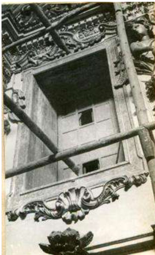
[Fig.4] Janela verdadeira tampada por painel em possível expansão da Igreja com a construção de cômodos laterais. Fonte: MOTTA, Edson. Relatório de conclusão da restauração das obras de pintura e talha da Igreja Matriz de São João del Rei e símula dos trabalhos . [ACI-R]/ Série Arquivo Técnico Administrativo / Subsérie: Restauração de Pintura - cx.004/pasta.20]. DPHAN. Rio de Janeiro, 1958.
