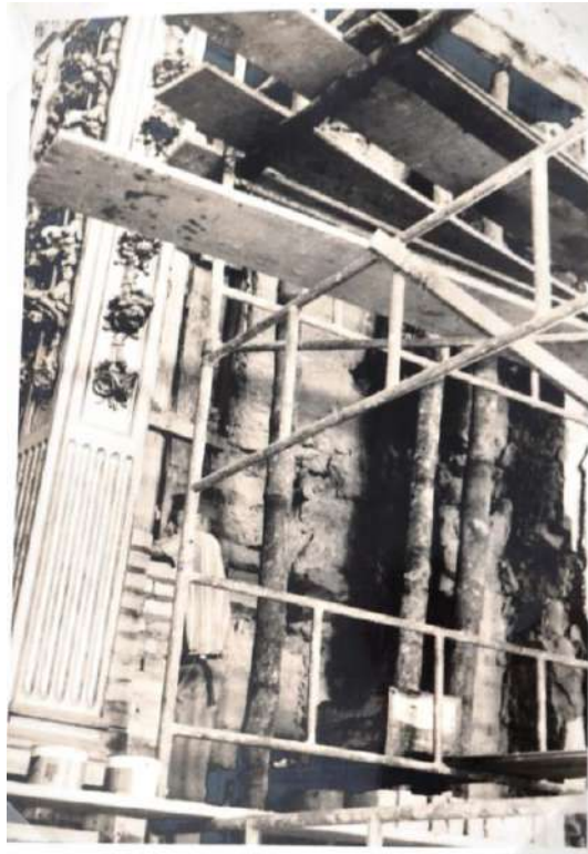
[Fig.5] Escoramento da parede de taipa (com trincas) e início das obras de pilastras de tijolos. Fonte: XAVIER FILHO, Geraldo Francisco. Relatório da restauração do altar de São Miguel na Catedral de Nossa Senhora do Pilar de São João del Rei/Minas Gerais . [ACI-R] / Série CRBC / Caixa s/número]. IPHAN. São João del- Rei, 1970.
