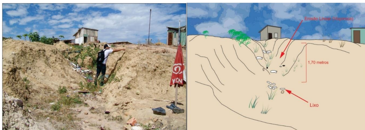
Figura 13 – Feição linear: A); Suceptibilidade a escorregamento; B) Processo erosivo (Voçoroca).
