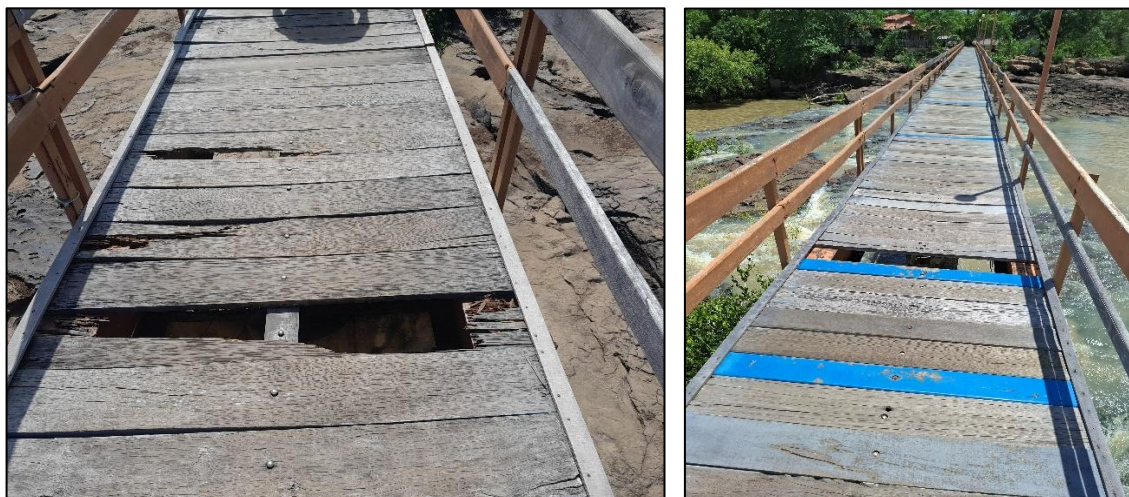
Figura 11 -Fotografias de trechos problemáticos da passarela de acesso na área da Cachoeira do Urubu, Piauí. Fonte: Sousa (2024).
